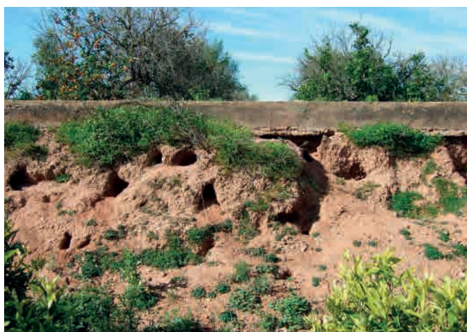
Detalle de acequia de riego descalzada parcialmente por las numerosas bocas que han hecho los conejos sobre el talud.
